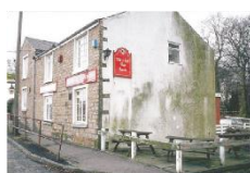
Fachada deteriorada por microrganismos
